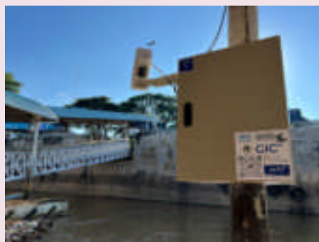
日本の援助と現地政府の協力で設置された CCTV 監視カメラ。映像はAI（人工知能）を使って分析
